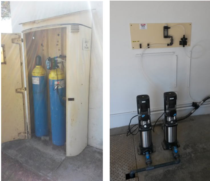
Photo 3 - système de chloration (bouteilles et hydroinjecteurs) du Puits des Canaux à BOUILLARGUES
