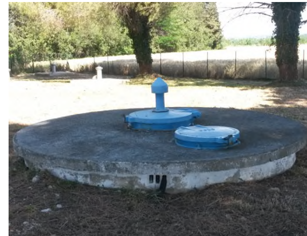
Photo 2 – Puits exploité (et vue de l'intérieur) du Puits des Canaux à BOUILLARGUES
